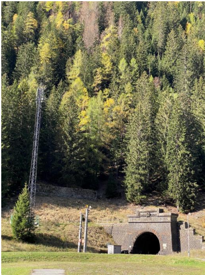
Borkenkäferbefall oberhalb Tauerntunnel Südportal, 2022 (ÖBB)
