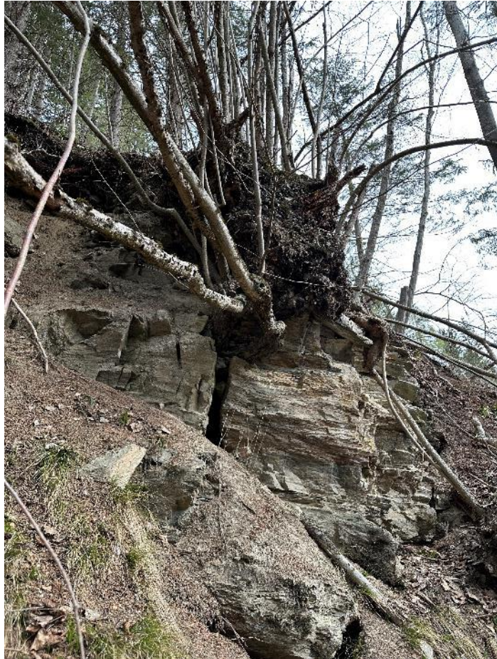
Erhöhtes Steinschlagrisiko, Pustertal, 2023 (ÖBB)
