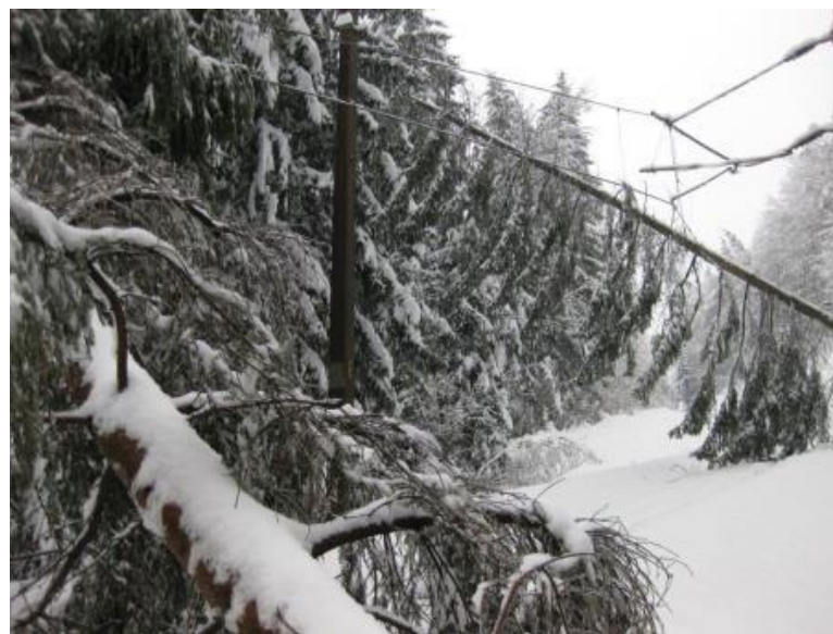
Schäden an der Oberleitung durch Schneebruch (ÖBB)
