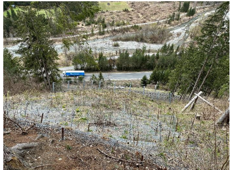
Oberflächenrutschung – Technische Schutzverbauung, Pustertal, 2023 (ÖBB)
