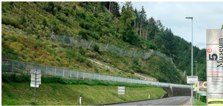
Das Projekt Sattelgraben im Süden des Stadtgebietes von Waidhofen im Bereich Krailhof schützt die Liegenschaften und den Radweg. Foto: WLW
